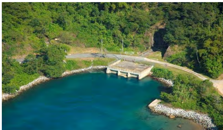
Saída da água de refrigeração dos condensadores principais de Angra 1 e Angra 2 - Saco da Piraquara de Fora
