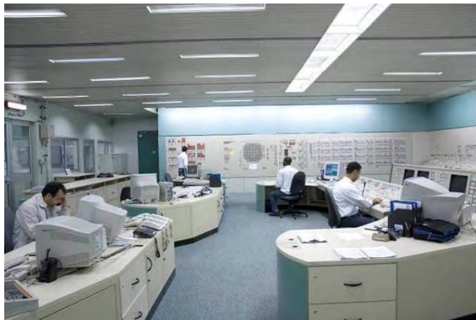
Sala de Controle – Angra 2
